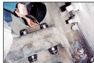
回転炉の分割ギア固定部分
